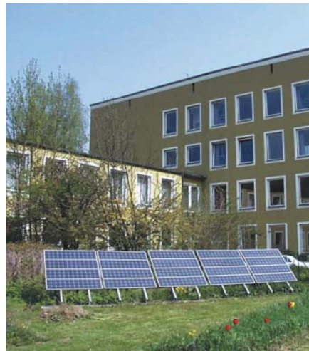
Photovoltaikanlage des Adalbert- Stifter-Gymnasiums in Passau
