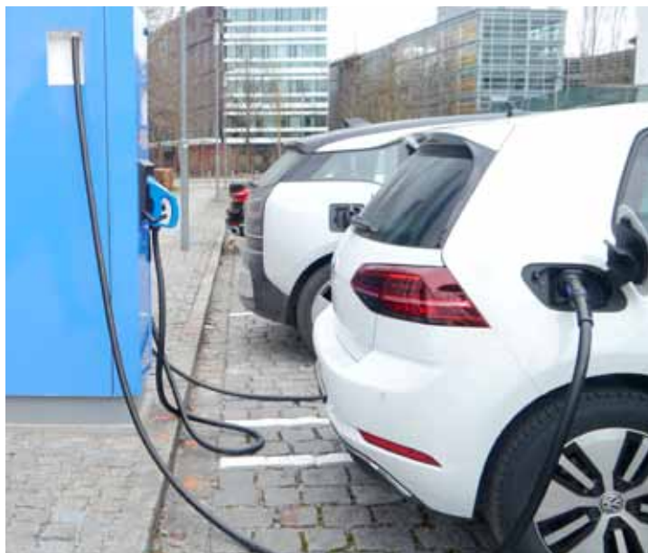
Abb. 9 + 10: Ladesäulen der Messe München zum Tanken von Ökostrom, produziert von der Photovoltaikanlage auf den Dächern der Messe München. Aussteller und Besucher können auf dem Münchner Messegelände seit Januar 2018 kostenlos Fahrstrom tanken (Fotos: Fabian Flade).
